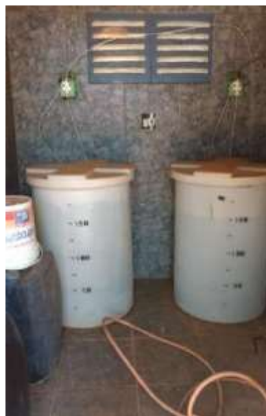
Foto 3.16 - Unidade de tratamento do Poço 06
