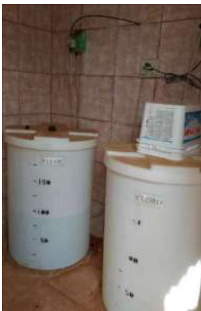
Foto 3.15 – Unidade de tratamento do Poço 05
