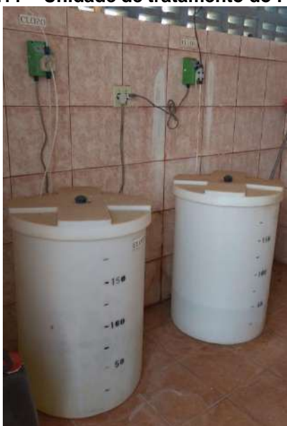
Foto 3.13 – Unidade de tratamento do Poço 03
