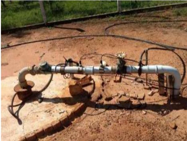
Foto 3.7 - Identificação do Poço: Poço 07
