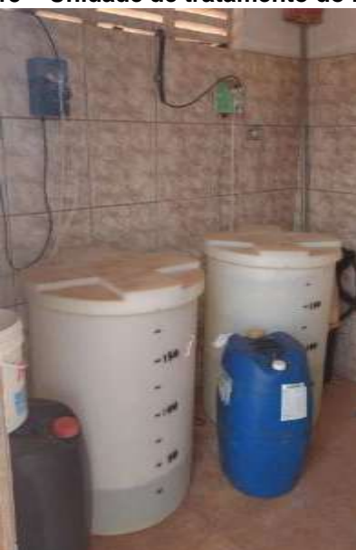
Foto 3.17 – Unidade de tratamento do Poço 07
