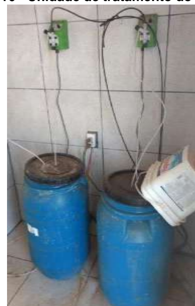
Foto 3.18 - Unidade de tratamento do Poço 08
