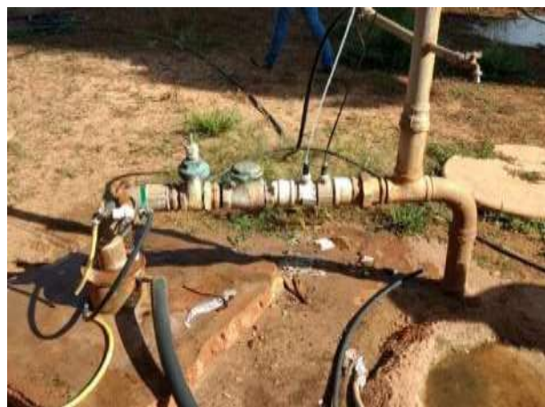
Foto 3.2 - Identificação do Poço: Poço 02
