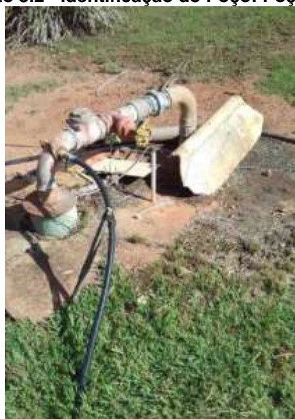
Foto 3.4 - Identificação do Poço: Poço 04
