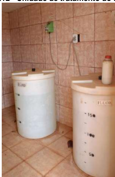
Foto 3.14 - Unidade de tratamento do Poço 04
