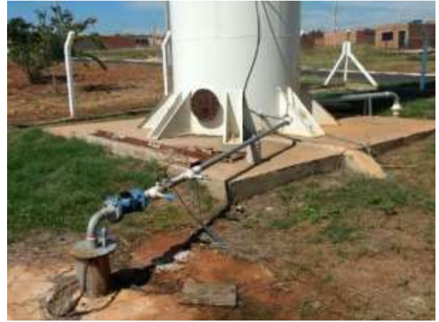
Foto 3.8 - Identificação do Poço: Poço 08
