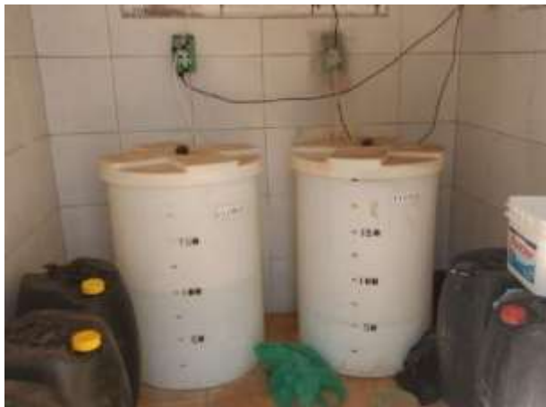
Foto 3.11 – Unidade de tratamento do Poço 01
