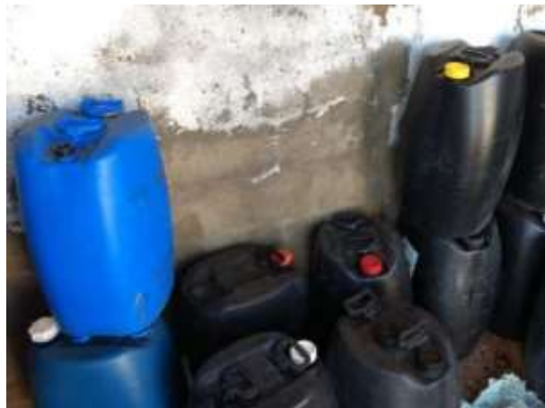
Foto 3.12 - Unidade de tratamento do Poço 02
